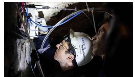
Montage Sensor Schlauchwaage - Hauptsammelkanal, Wien | AT
